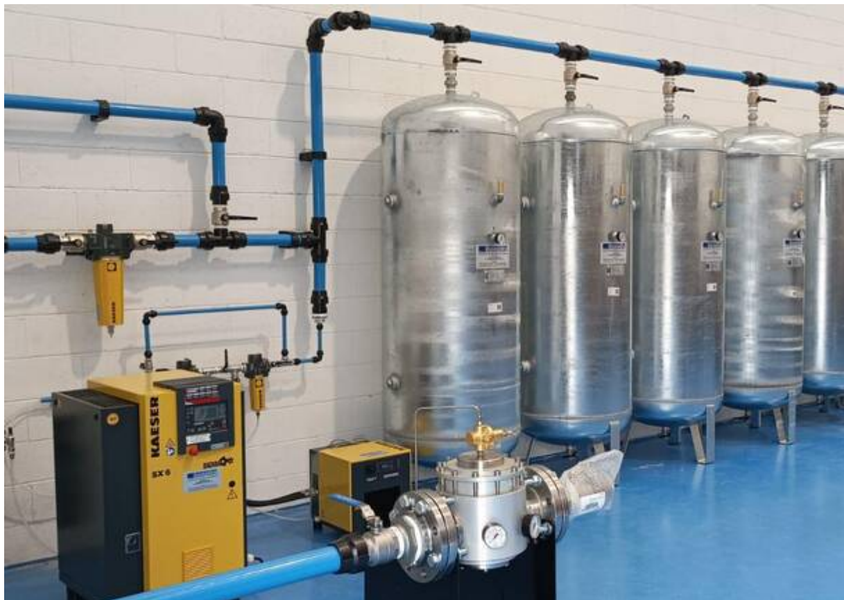
Impianto aria compressa
